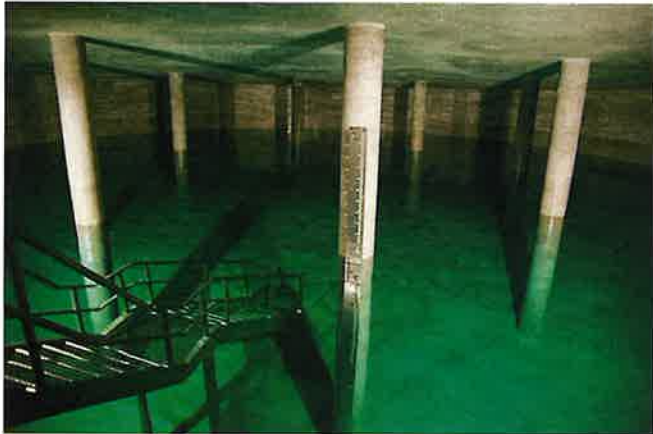
Reinwasserbehälter im Wasserwerk Hergershausen
